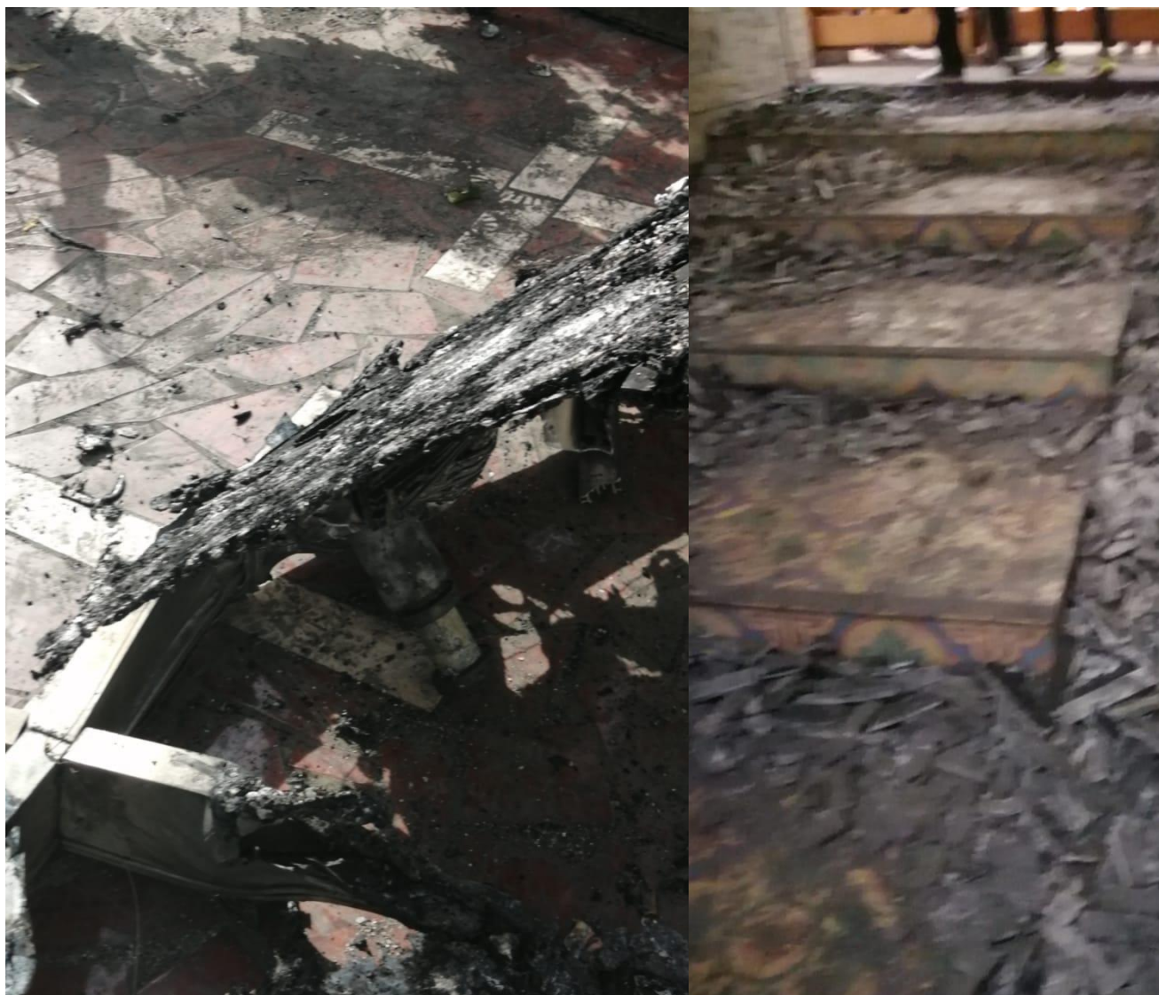
En estas imágenes se evidencia la destrucción de la capilla, hay restos de la cúpula, cenizas y azulejos en el suelo.. Foto: CENIDH
